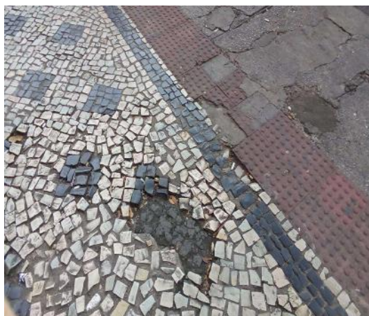
Figura 6: Piso tátil necessitando de reparos. – Estação Carijós.
