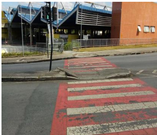
Figura 42: Travessia de pedestres na Rua Barragem da Pampulha. – Estação Pampulha.
