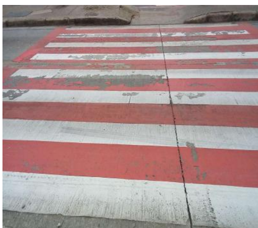
Figura 34: Condição de uma das faixas de pedestre na Avenida Presidente Antônio Carlos. – Estação UFMG.
