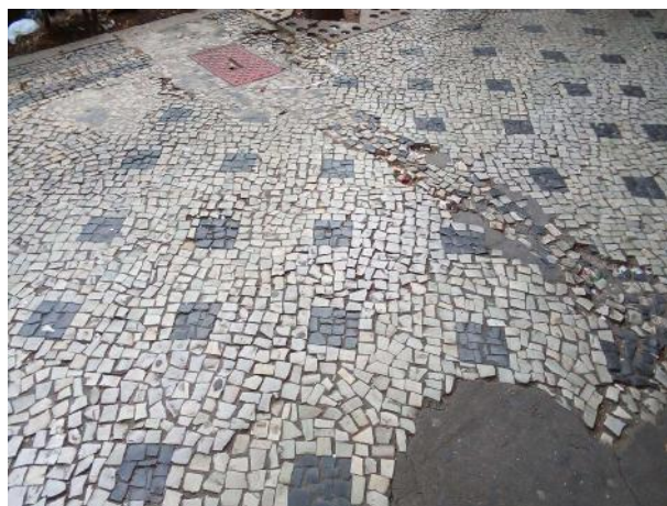
Figura 8: Calçada com buracos e muitos remendos. – Estação Carijós.
